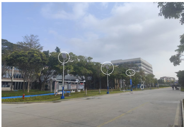
厂内太阳能路灯
