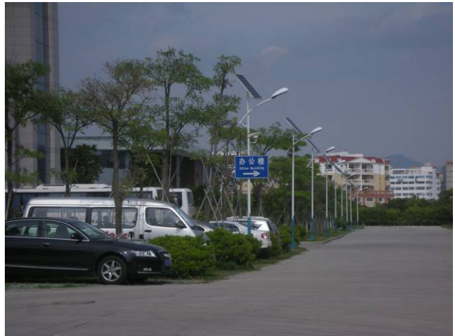
厂内太阳能路灯
